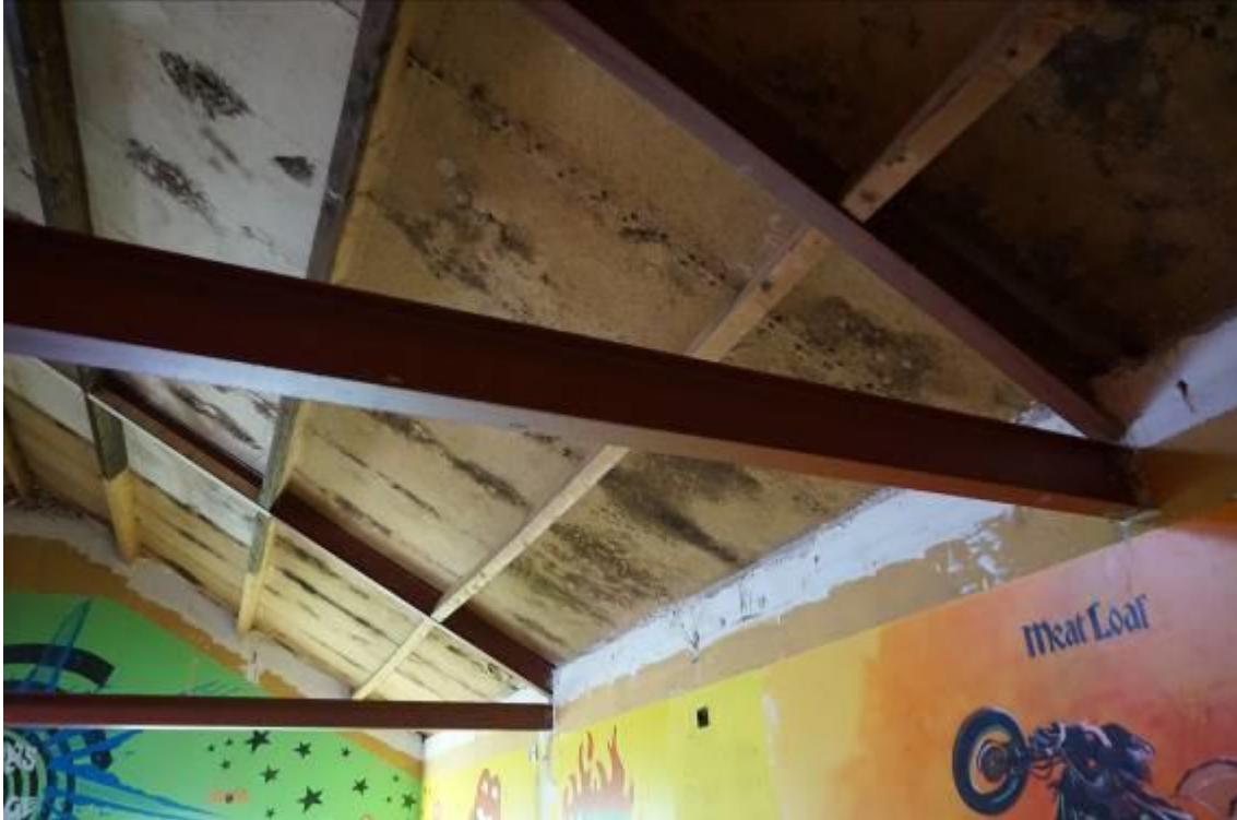
Figuur 5.2 Vochtig en beschimmeld plafond in discotheek.
