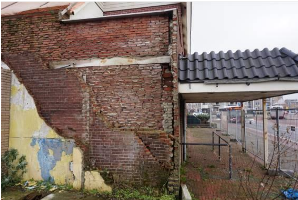
Figuur 5.3 Sterk beschadigde buitenmuur discotheek
