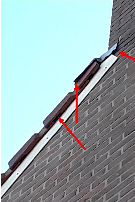
Foto 7 Strakke gevelpannen met voor vleermuizen geschikte openingen onder pannen en loodslab.
