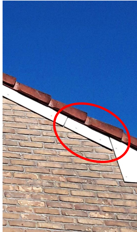
Foto 8 Strakke gevelpannen, kieren tussen trespdelen.
