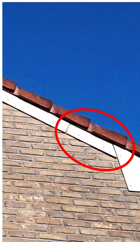
Foto 8 Strakke gevelpannen, kieren tussen trespa delen.
