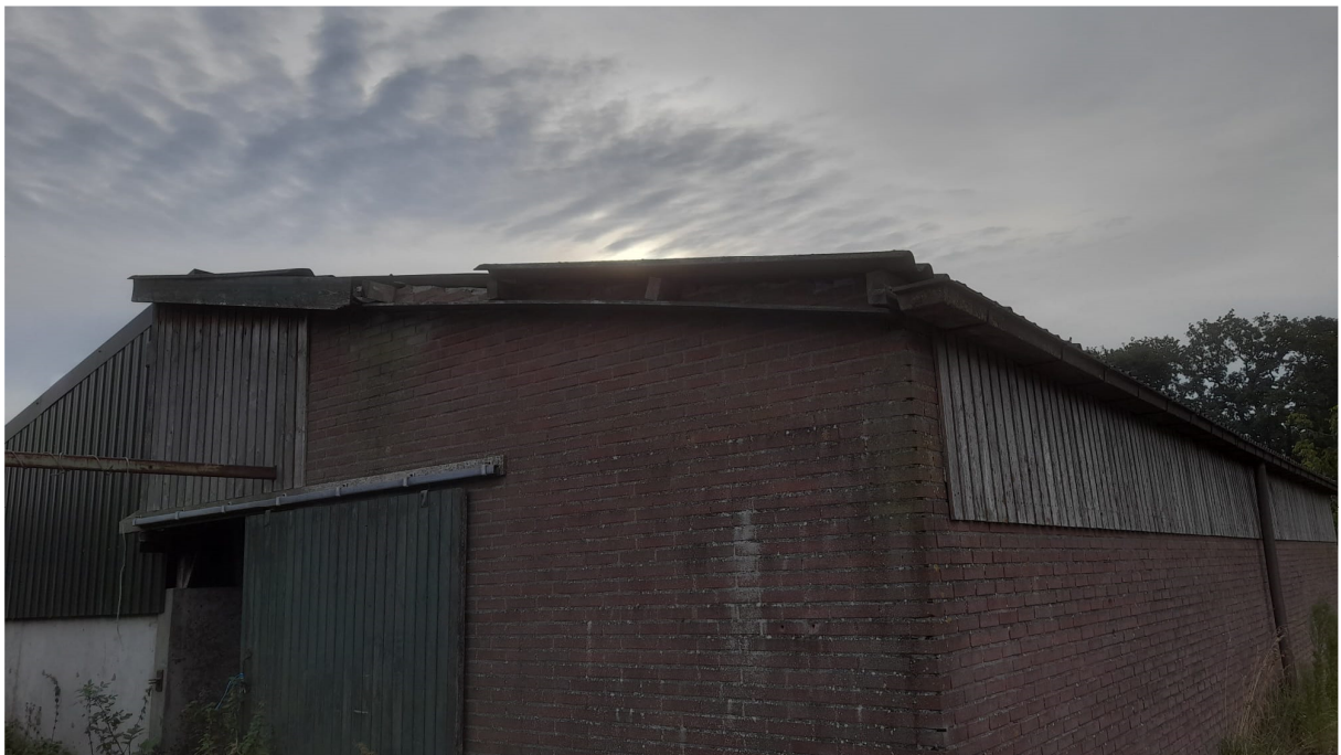
Foto 2; Beschadigde asbestverdachte golfplaten
