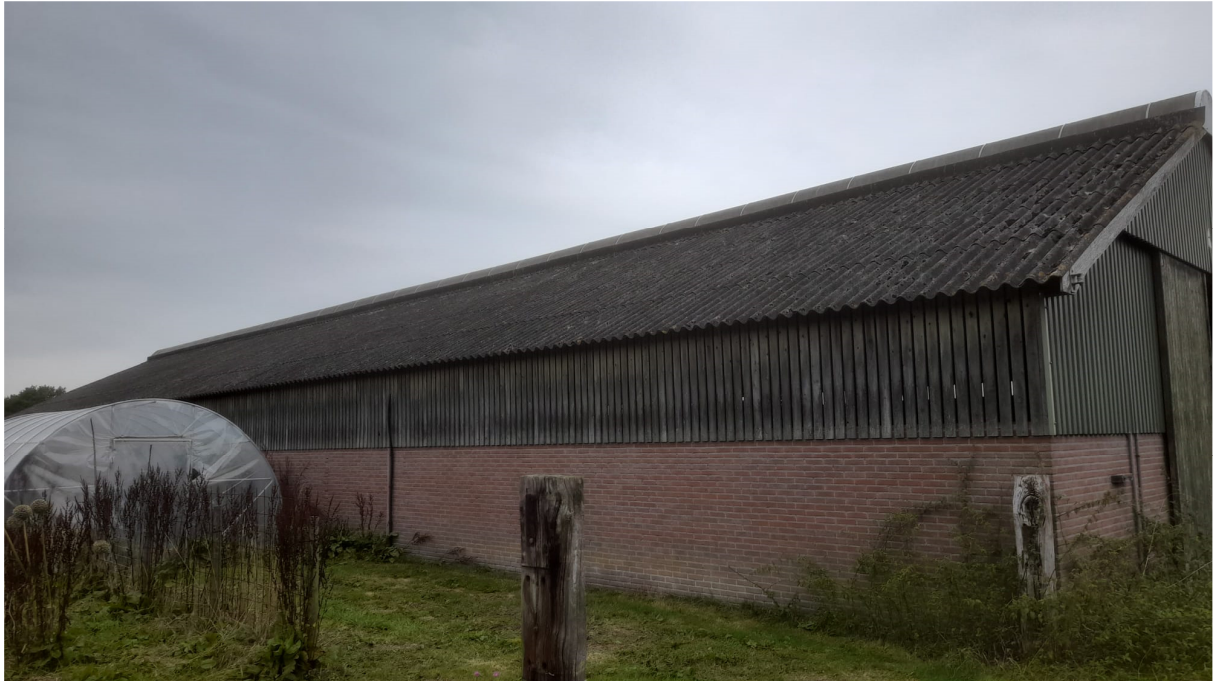
Foto 1; Asbestverdachte golfplaten zonder goten
