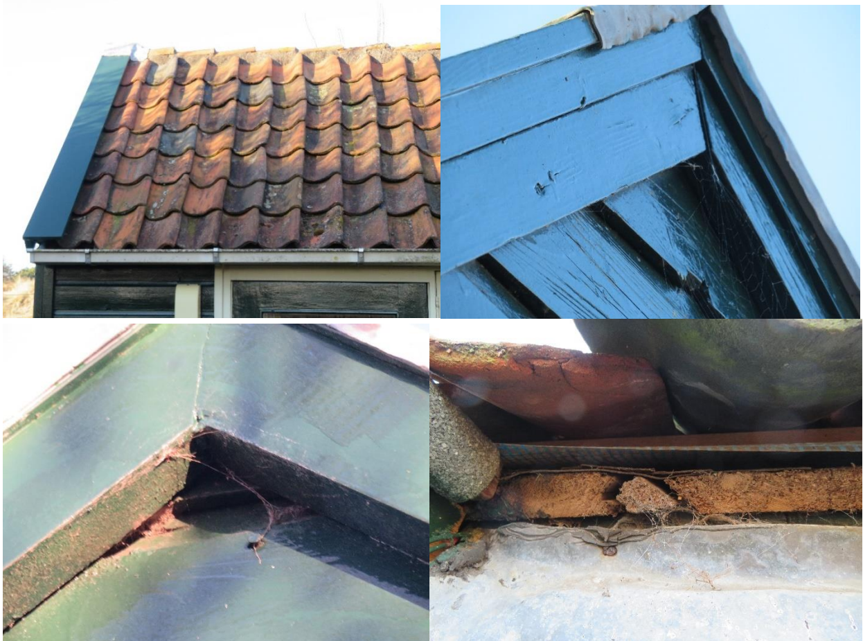
Afbeeldingen 8, 9, 10 en 11: Close-ups van pannen, gevelbetimmering en dakbeschot onder de pannen.
