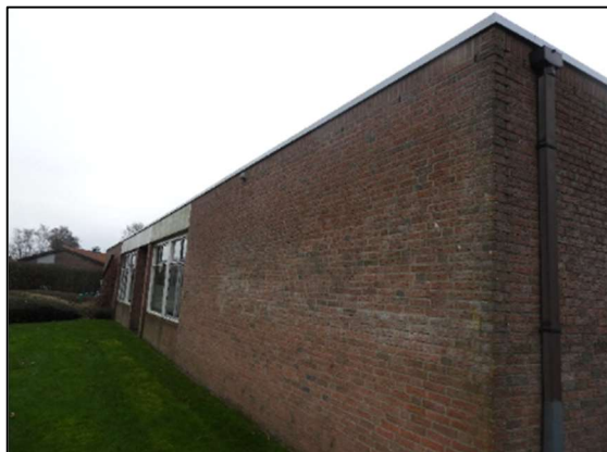
Afbeelding 1.3. Bakstenen muur met open stootvoegen.
