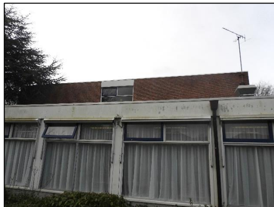
Afbeelding 2.7. Houten kozijnen en open stootvoegen in muur op 1 e verdieping.
