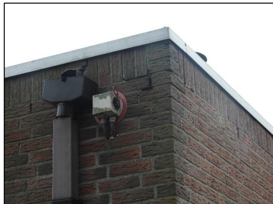
Afbeelding 2.5. Open stootvoegen in noordelijke deel van schoolgebouw.
