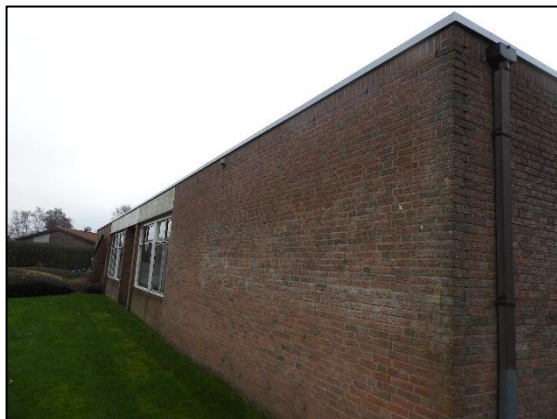
Afbeelding 2.6. Bakstenen muur met open stootvoegen.
