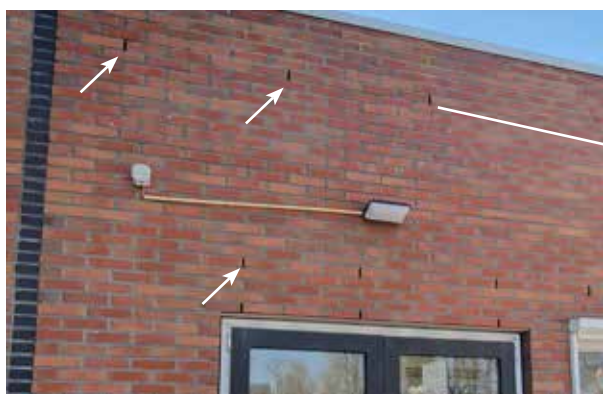
Figuur 13. Meerdere open stootvoegen in het pand.
