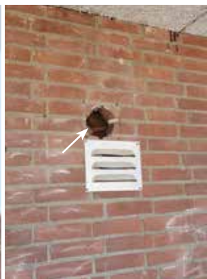
Figuur 18. Gat in de muur.
