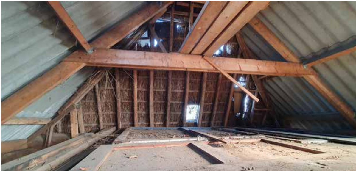
Figuur 11. Ontbrekend dakbeschot onder het golfplatendak en vervallen rietdakbedekking.
