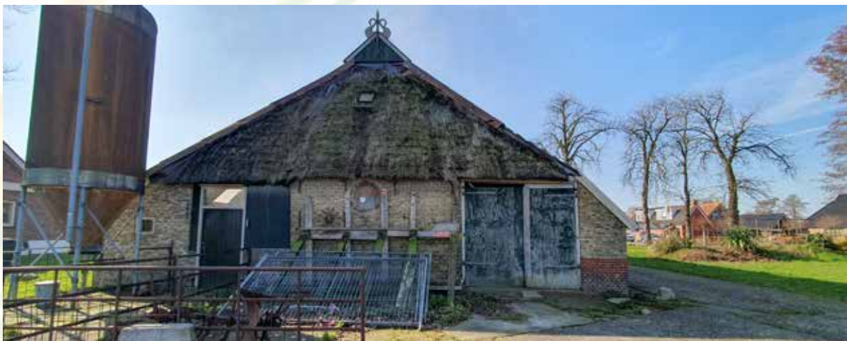
Figuur 2. Impressie van het plangebied aan oostzijde (achterzijde) met gestutte muur en vervallen rietdak.
