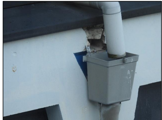
Afbeelding 2.5. Gat achter waterafvoersysteem.
