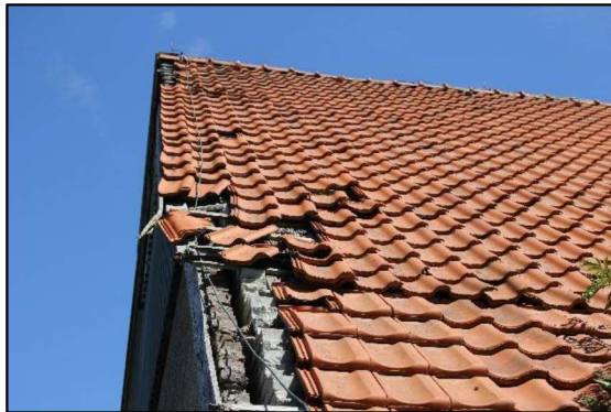
Afbeelding 2.4. Dak van vervallen schuur
