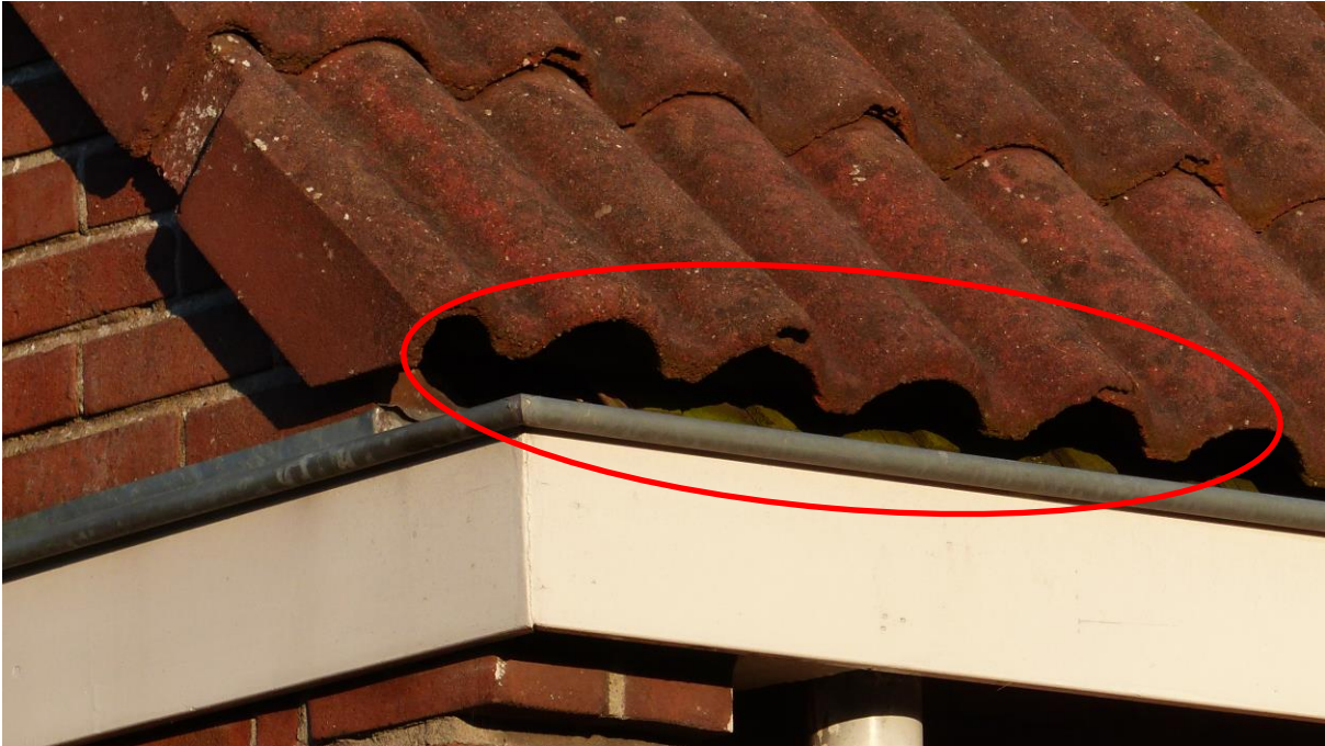
Figuur 4.3 Onder de eerste rij dakpannen kunnen huismussen tot broeden komen.
