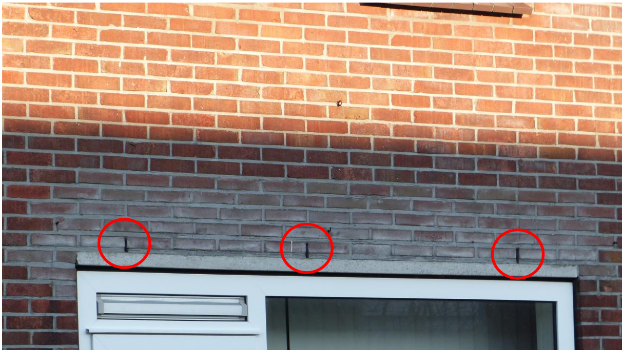
Figuur 4.4 De woningen binnen het plangebied hebben stootvoegen welke vleermuis toegang tot de spouw bieden.
