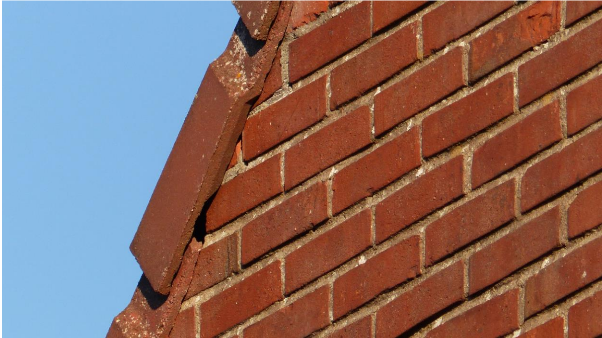
Figuur 4.1 De kantpannen zijn strak op de gevels aangebracht, waardoor niet voldoende invliegruimte voor gierzwaluw aanwezig is. Wel zijn de openingen geschikt voor vleermuizen.
