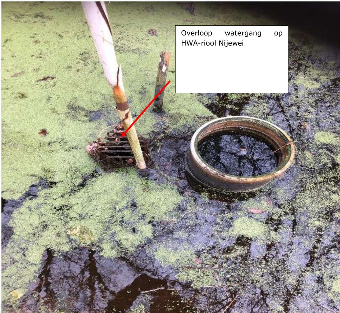
Afbeelding 5: overloop watergang naar HWA-riool Nijewei
