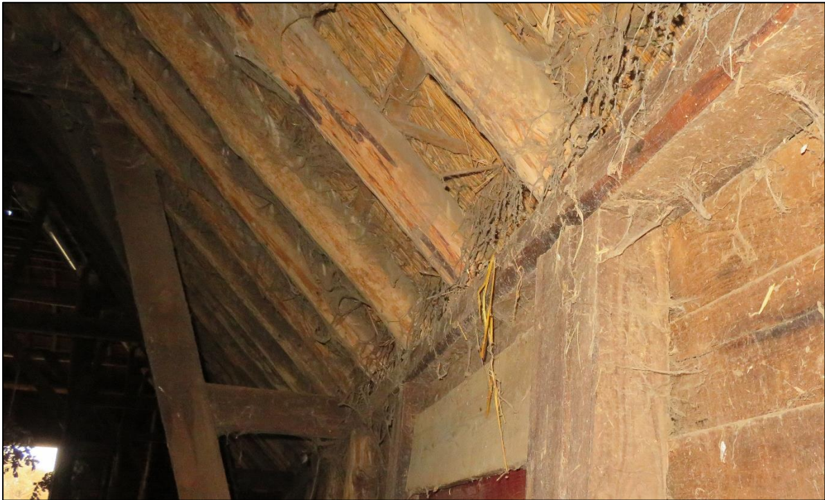
Afb 17: Binnen ter plaatse van de doorbraak ook geen geschikte openingen voor vleermuizen
