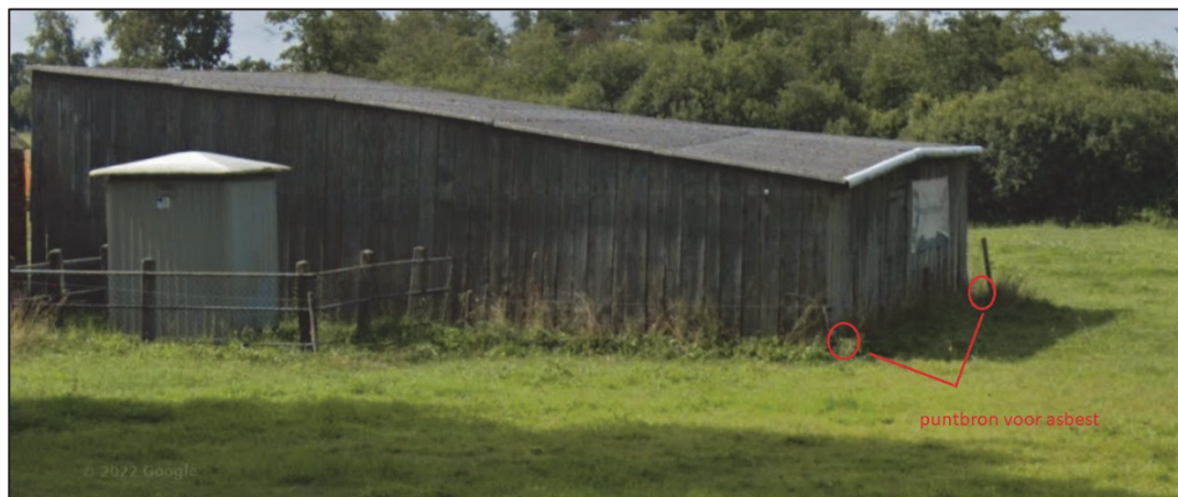
Foto puntbron asbest bij kapschuur
