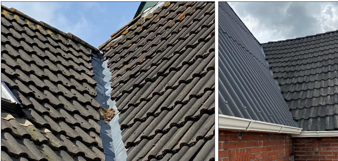
Foto's 7 en 8. Onder de dakpannen bevinden zich ruimtes die mogelijk geschikt zijn voor huismus om in te broeden. Op foto 7 is mogelijk oud nestmateriaal te zien.
