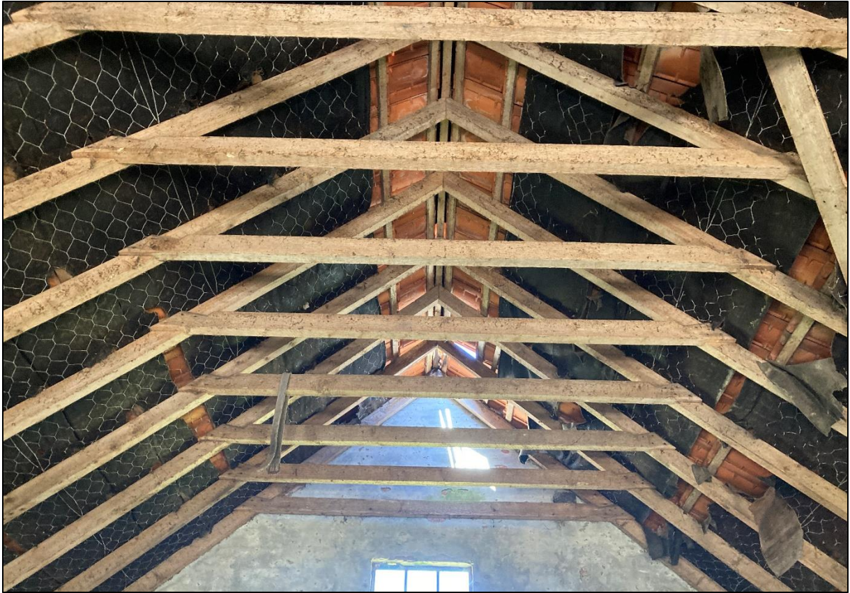
Figuur 6. De kleine schuur heeft enkel gedeeltelijke isolatie onder de dakpannen, er is geen dakbeschoot aanwezig voor gierzwaluw om nesten te maken
