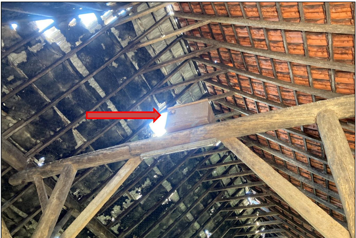
Figuur 7. De grote schuur biedt geen enkele nestruimte aan bijvoorbeeld huismus of gierzwaluw. Er is wel een nestkast voor kerkuil aanwezig (rode pijl)
