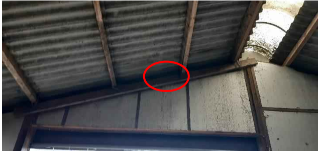
Figuur 5.1: Locatie van één houtduivennest boven de noordelijke roldeur.
