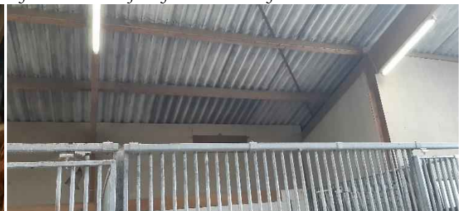
Figuur 3.9: Houten skelet met asbesthoudende dakbeplating.
