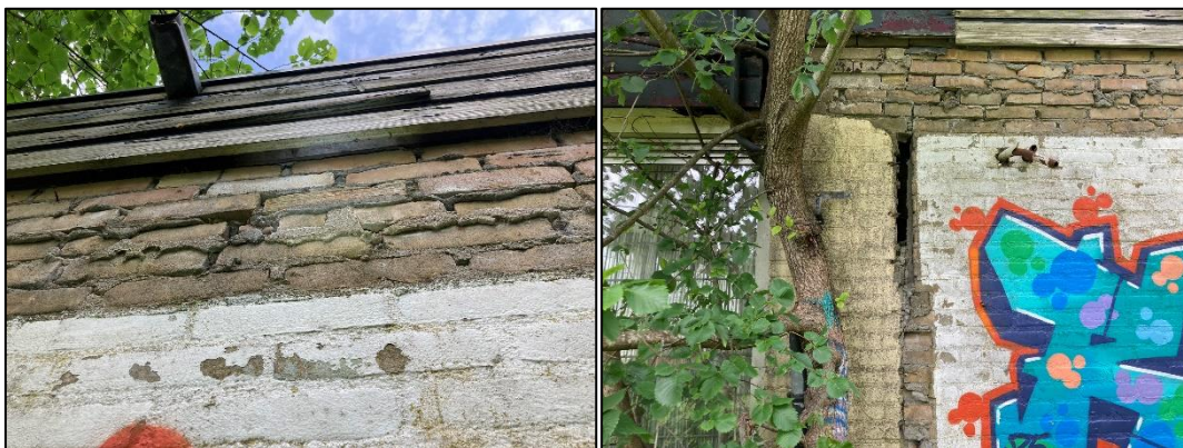
Figuur 2.17 (links): De daklijst sluit goed aan op de gevel.; Figuur 2.18 (rechts): De gevel vertoont op diverse plekken gaten waar voorheen een deel van de bebouwing aangesloten is geweest.
