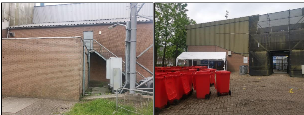
Figuur 2.7 (links): Aangrenzend aan de tribune aan de westzijde staat een bijgebouw met gemetselde muren en enkele kieren. Het bijgebouw heeft deels een golfplaten dakbedekking en deels een plat dak; Figuur 2.8 (rechts): Zijaanzicht van tribune aan de zuidzijde.
