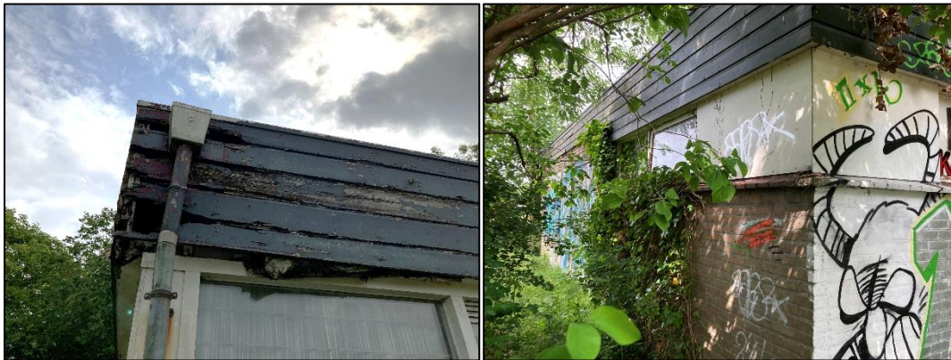
Figuur 2.15 (links): Impressie van de dakrand, welke in slechte staat van onderhoud verkeert. Hierbij zijn diverse gaten waarneembaar; Figuur 2.16 (rechts): Impressie van de achterzijde van het gebouw. Deze is deels overgroeid.
