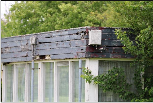
Figuur 2.19: Impressie van de daklijst van het bijgebouw, welke in slechte staat van onderhoud verkeert. Hierbij zijn diverse gaten waarneembaar.
