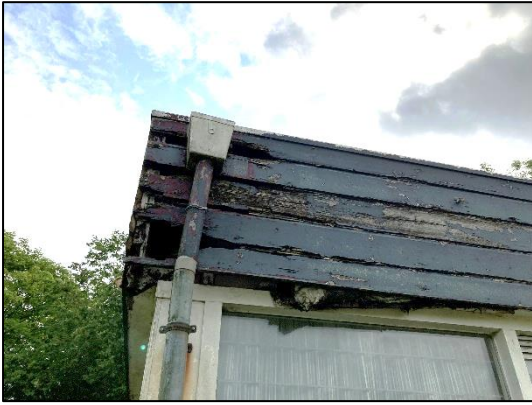
Figuur 6.6: Impressie van de daklijst van het bijgebouw aan de oostzijde van het plangebied. Deze vertoont op meerdere plekken gaten welke mogelijk tot een holte leiden. Alhoewel matig geschikt, wordt niet op voorhand uitgesloten dat deze als zomerverblijf gebruikt kan worden. Mogelijk voorkomende soorten: Gewone dwergvleermuis, ruige dwergvleermuis en laatvlieger.
