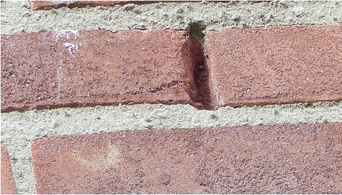
Afbeelding 3 De aanwezige stootvoegen zijn of te laag of zitten dicht met rode specie.
