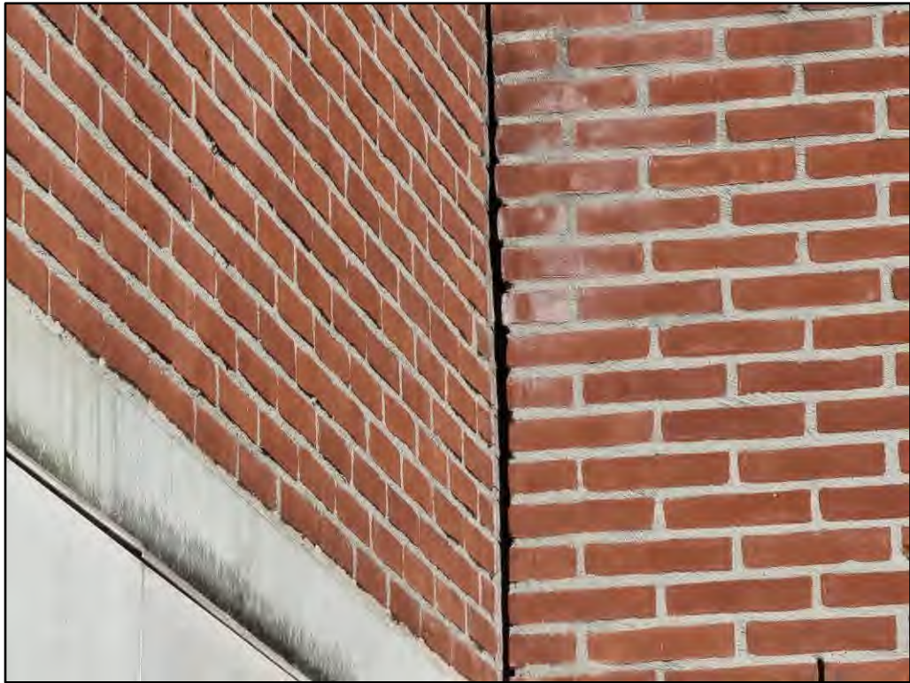
Figuur 3 De bebouwing bevat op verschillende plaatsen open stootvoegen en dilatatievoegen.
