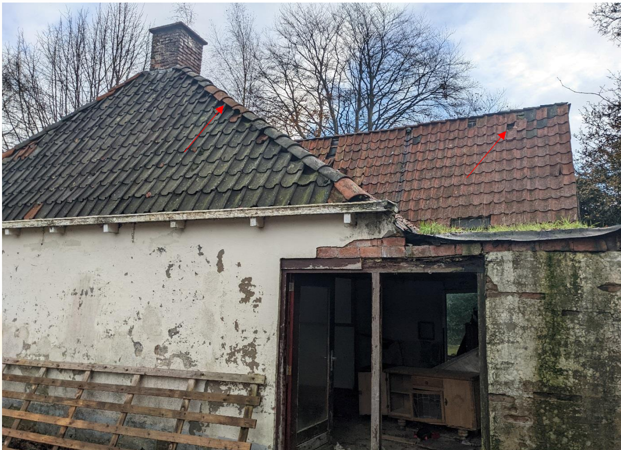
Figuur 7. Voorbeelden van Invliegopeningen (rode pijlen) vleermuizen en huismuis in bedrijfswoning.
