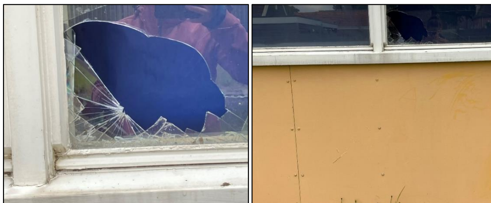
Figuur 6.2 (links): Het gat in het raam; Figuur 6.3 (rechts): de trespa platen onder het gat.
