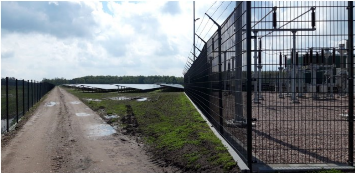
Figuur 2.7 Rechts aanzicht op de schakeltuin en links het bestaande zonnepark
