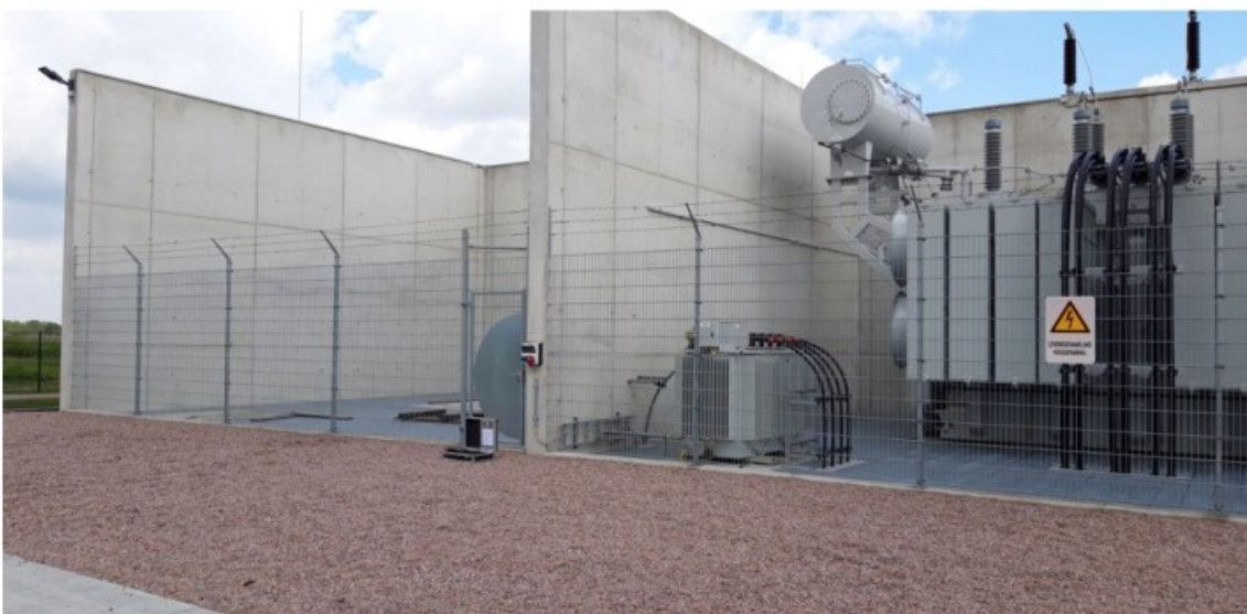
Figuur 2.3 Vooraanzicht; rechts bestaande trafo, links compartiment voor uitbreiding (2e trafo)
