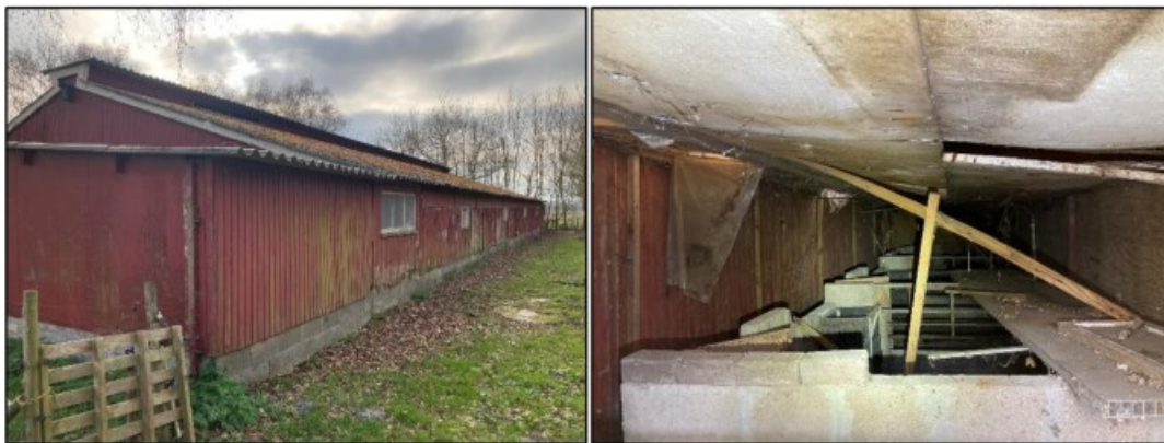
Figuur 2.8 (links): De noordzijde van de varkensstal; Figuur 2.9 (rechts): De binnenkant van de schuur die zich aan de westzijde direct aan de varkensstal bevindt. Ook deze is in vervallen staat.
