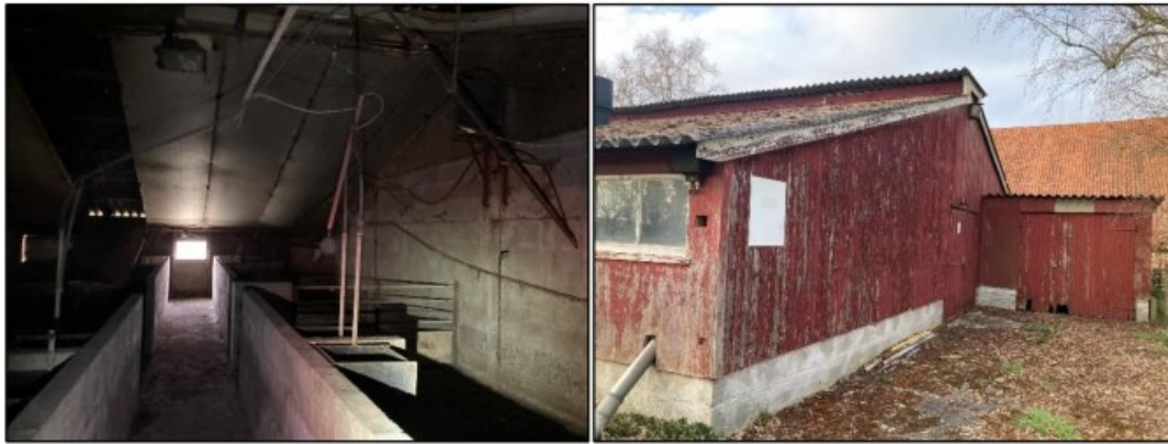
Figuur 2.6 (links): De binnenkant van de varkensstal maakt een vervallen indruk. Dakisolatie komt los en elektra hangt vrij; Figuur 2.7 (rechts): De oostzijde van de varkensstal, met aan de rechterzijde een schuur. In de schuur vindt opslag van materialen plaats.
