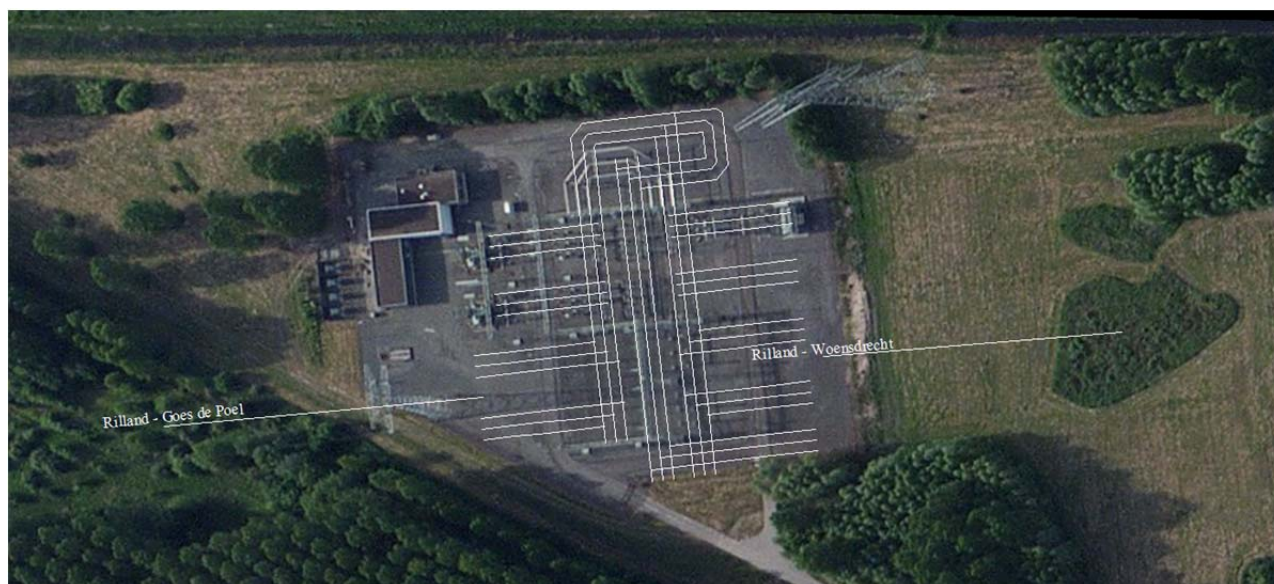
Figuur 1 Overzicht 150 kV hoogspanningsstation Rilland
