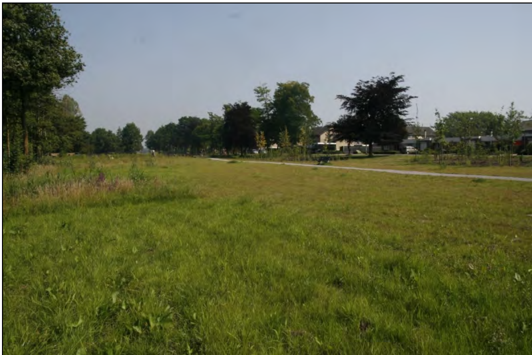
Ten behoeve van de aanleg van bergbezinkbassins zijn grote ingrepen gepleegd in het plangebied. De bovenste foto toont de locatie van een bergbezinkbassin in aanleg. De onderste foto toont het heringezaaide plantsoen, waaronder aanvoerbuizen zijn aangelegd.
